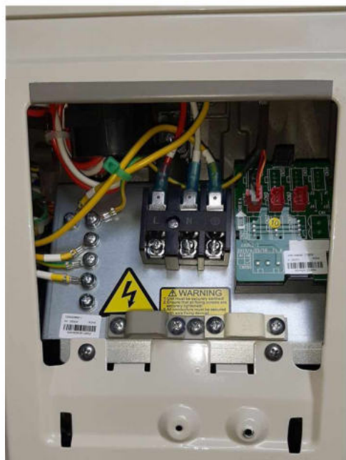
Wygląd części elektrycznej jednostki zewnętrznej (zdjęcie powyżej)
